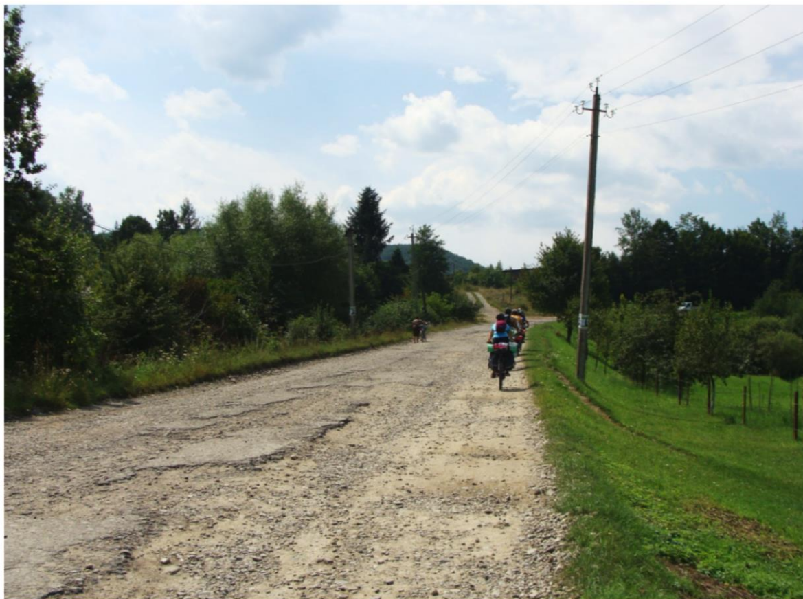
Фото 72. Асфальтова дорога по с. Яблунів майже зовсім зруйнована
