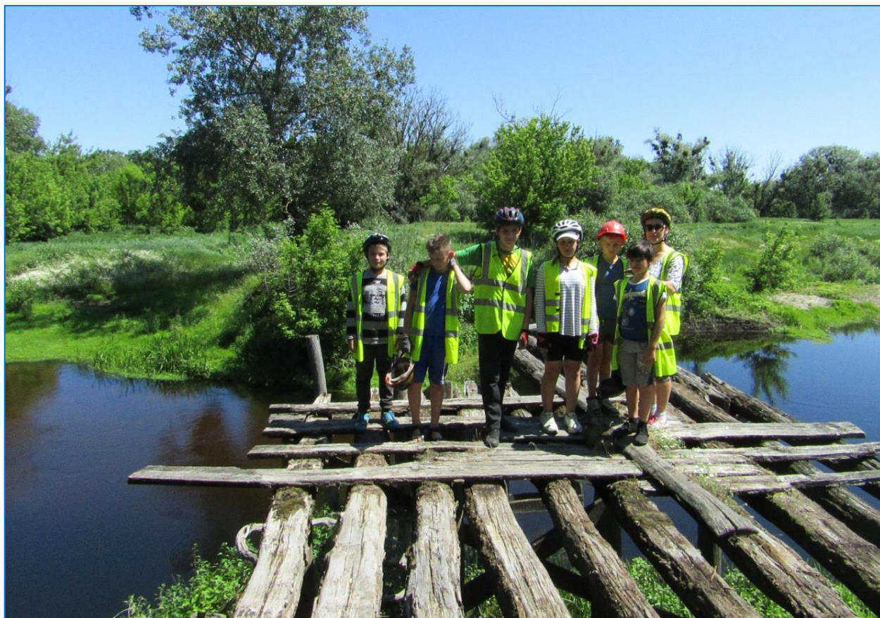
Фото 3.12. Зруйнований міст у с. Журавне
