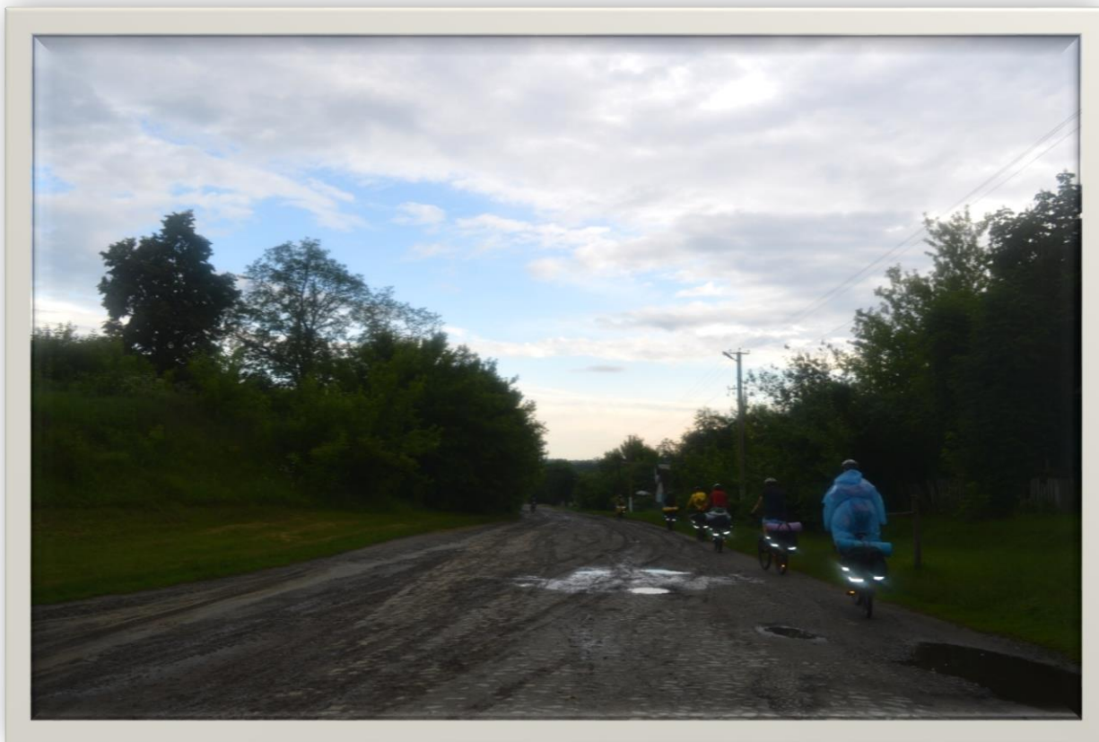
Фото 51. Розбите дорожнє покриття
