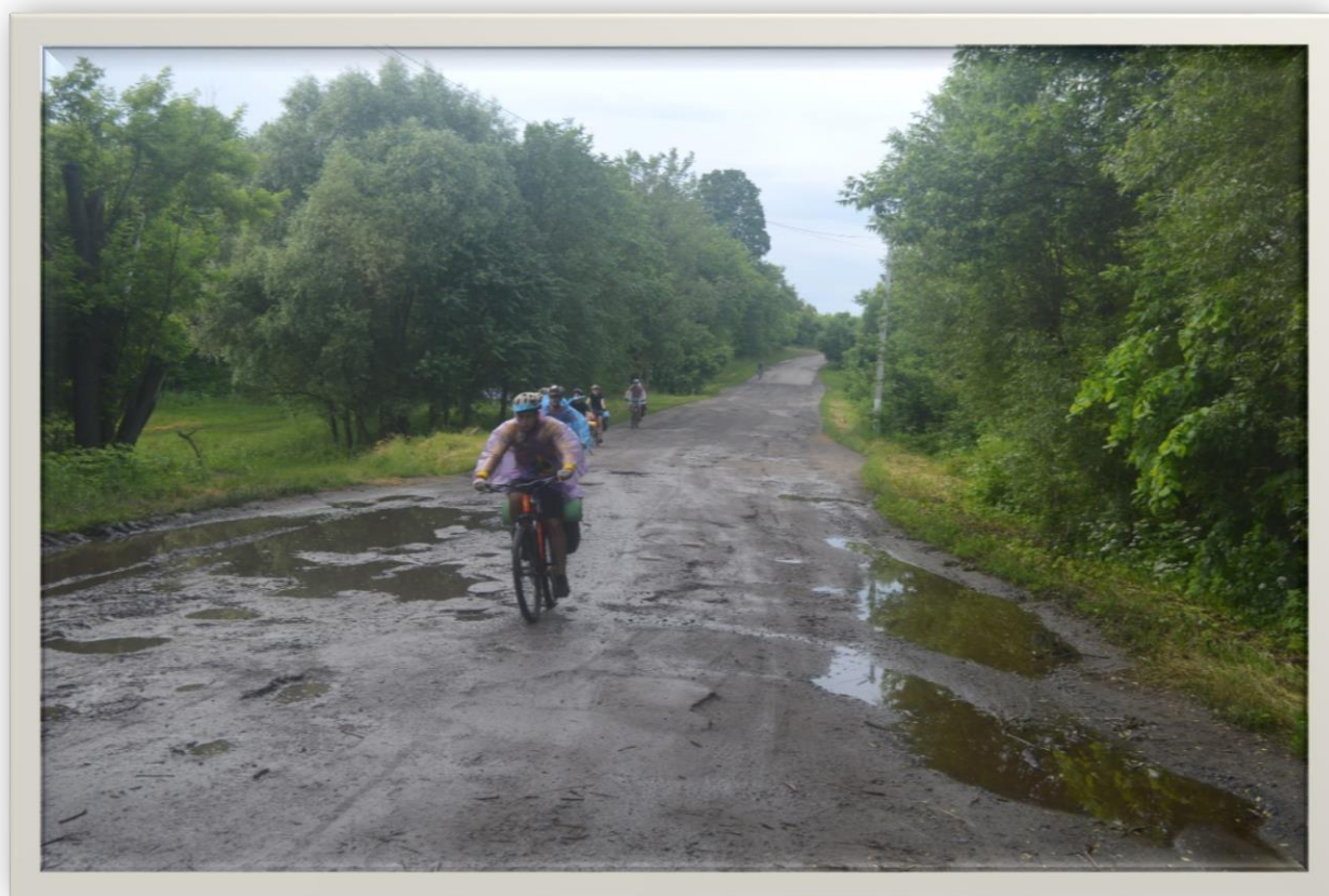
Фото 50. Зруйнований асфальт в с. Осоївка
